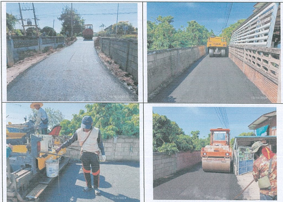
4.13 โครงการปรับปรุงถนนโดยวิธีเสริมผิวลาดยางแอสฟัลท์คอนกรีต สถานที่ ซอย ๕ บ้านเจดีย์สามยอด หมู่ที่ ๖
